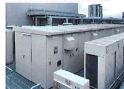
■ 屋上の高圧受変電設備
